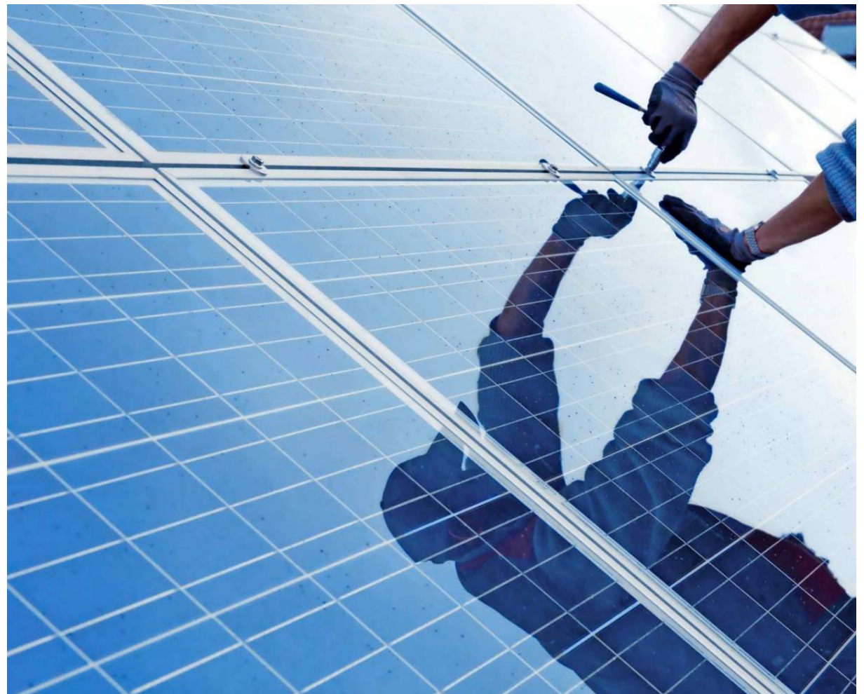
Installation einer Photovoltaikanlage. Sie soll 25 bis 30 Jahre in Betrieb sein. FOTO: SIMONKRAUS FOTALLIA
